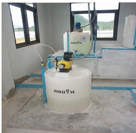
รูปที่ 20 เครื่องจ่ายสารละลายคลอรีน
