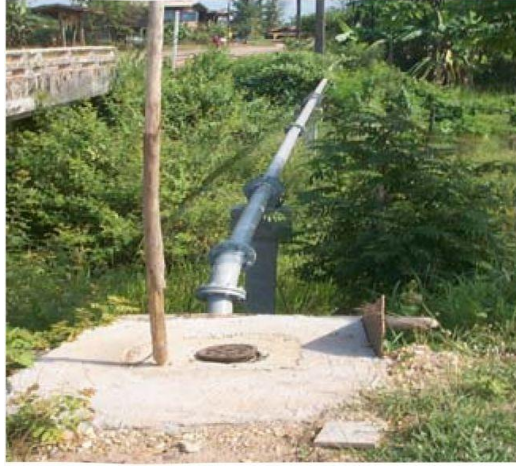
รูปที่ 19 ท่อส่งน้ำดิบระบบประปาแบบบาดาล
