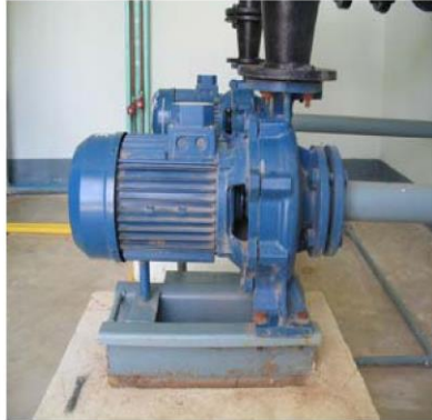
(2) โรงสูบน้ำดิบ
