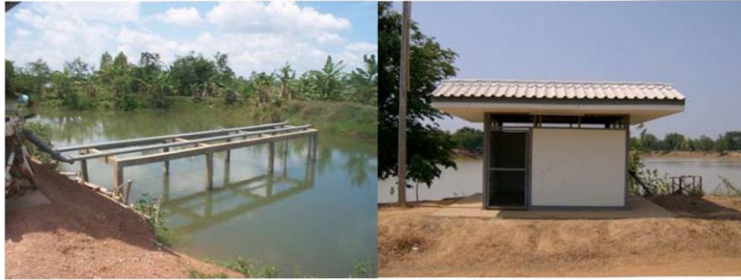
รูปที่ 23 -24 (จากซ้ายไปขวา) ท่อส่งน้ำดิบระบบประปาแบบผิวดิน และ โรงสูบน้ำดิบ
